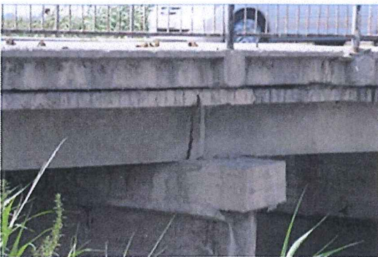
コンクリートにひび
